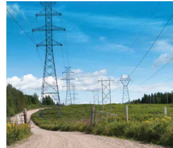
Les pylônes supportent les conducteurs des lignes aériennes à haute tension. Leur forme, leur hauteur et leur robustesse dépendent des contraintes auxquelles ils sont soumis.
